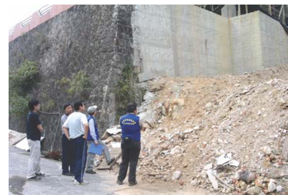
▲山坡地違規設置擋土牆
