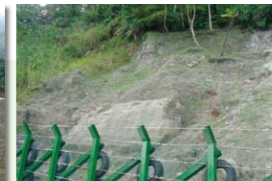
五指山登山步道旁崩塌地處理工程
