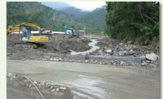
嘉義縣中埔鄉中崙村中崙四號橋緊急搶通
