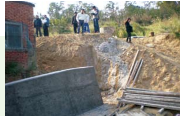
違規開挖整地闢建擋土牆
