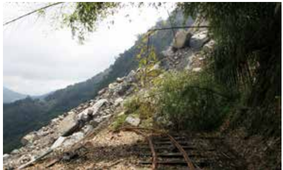
▲圖1 多林段崩塌區
