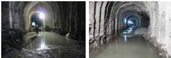
▲圖 14 新舊隧道銜接斷面滲水
