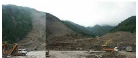
▲大鹿林道1公里處土場崩場地及土場溪災害處理情形（93.9.15）
