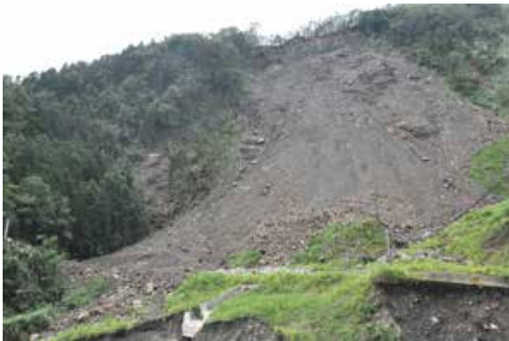
▲大鹿林道1.5K受災情形
