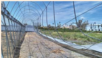
▲溫室內部無補強結構損壞案例多
