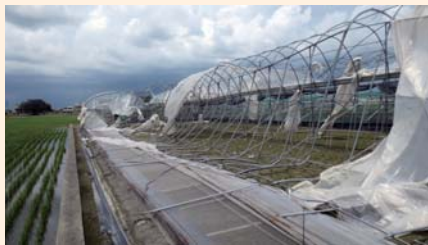
▲溫室設施受強颱侵襲結構嚴重坍塌
