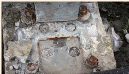
▲由設施基礎柱之焊接處斷裂
