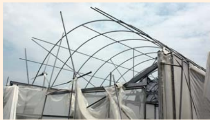
▲由管件接合零件處鬆脫破壞
