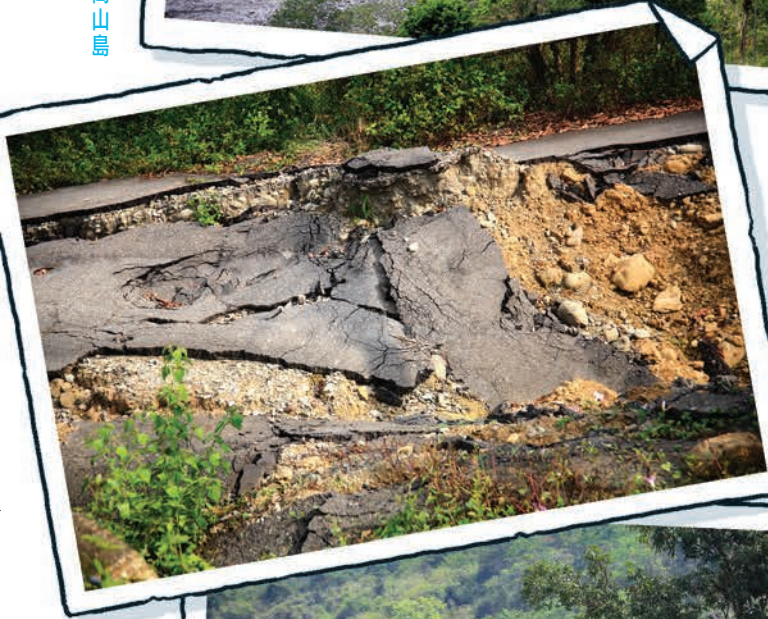
地震山崩道路裂開
