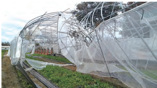
簡易溫室結構管件主柱拔起損壞
