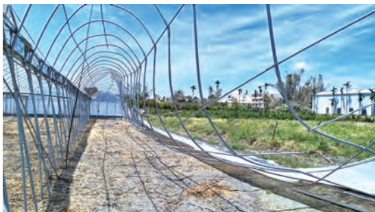
簡易溫室結構管件彎曲坍塌
