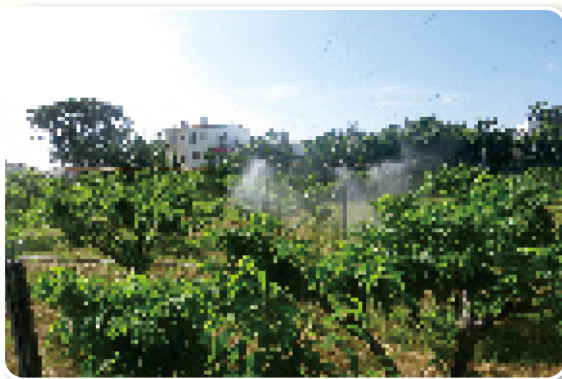
圖8. 微霧噴頭果園安裝及加濕情形
