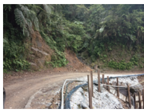
▲內洞林道6.1公里處因坑溝沖刷路基流失
