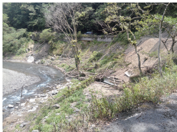
▲桶后林道10.3公里處桶後溪凹岸淘刷嚴重
