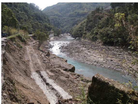
▲南勢溪隱瀑橋上游護岸損毀
