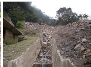
▲平廣路151號旁坑溝大量土石下移掩埋民宅
