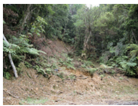
▲內洞林道5.7公里處崩塌
