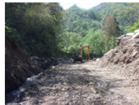
▲平廣路273號旁坑溝大量土石下移淤滿河道
