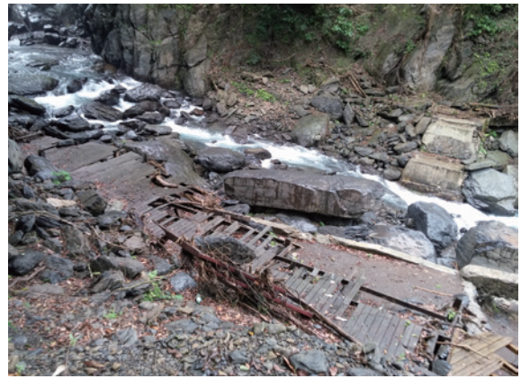
▲內洞溪下游兩岸構造物損毀
