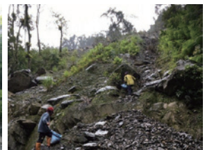
▲104年國追13號崩塌地復育工作
