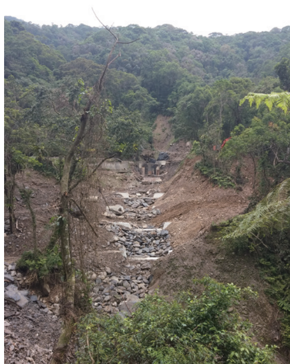
▲內洞林道6.5公里處大面積崩塌
