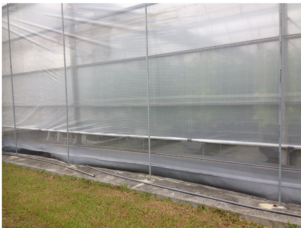
圖 3. 設施於豪雨侵襲時應視天候降下天窗及側捲簾等披覆。
