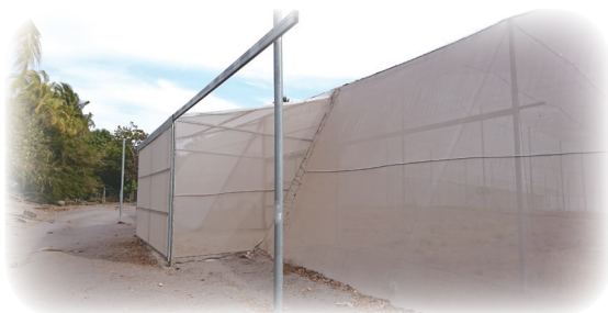
圖 16. 墨西哥直立柱斜拉地錨式水平網室
