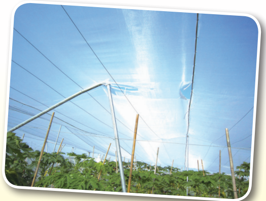
圖 5. 網室上方橫樑連接處脫落情形
