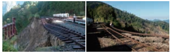
▲圖1、莫拉克後二萬坪月台邊坡滑落情形（拍攝日期：98年9月）
