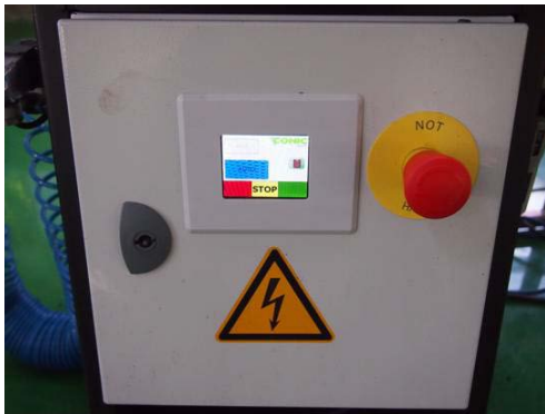
圖十、控制箱 Fig. 10. Control box
