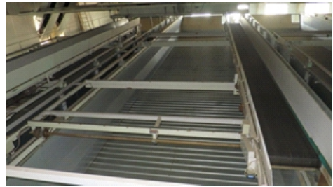
圖三、茶菁貯存槽
