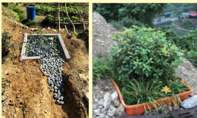
圖二、坪林地區設置之不同型式植生滯留槽
