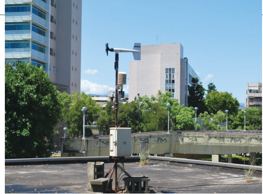
林試所育西樓頂風速風向、溫濕度等監測設施。
