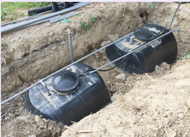
圖一、地下儲水槽。
