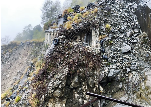
圖10、眠月線#1隧道坍方現況。
