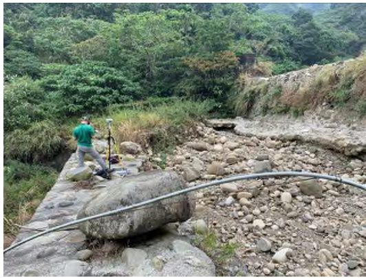
(a) 消能池毀損
