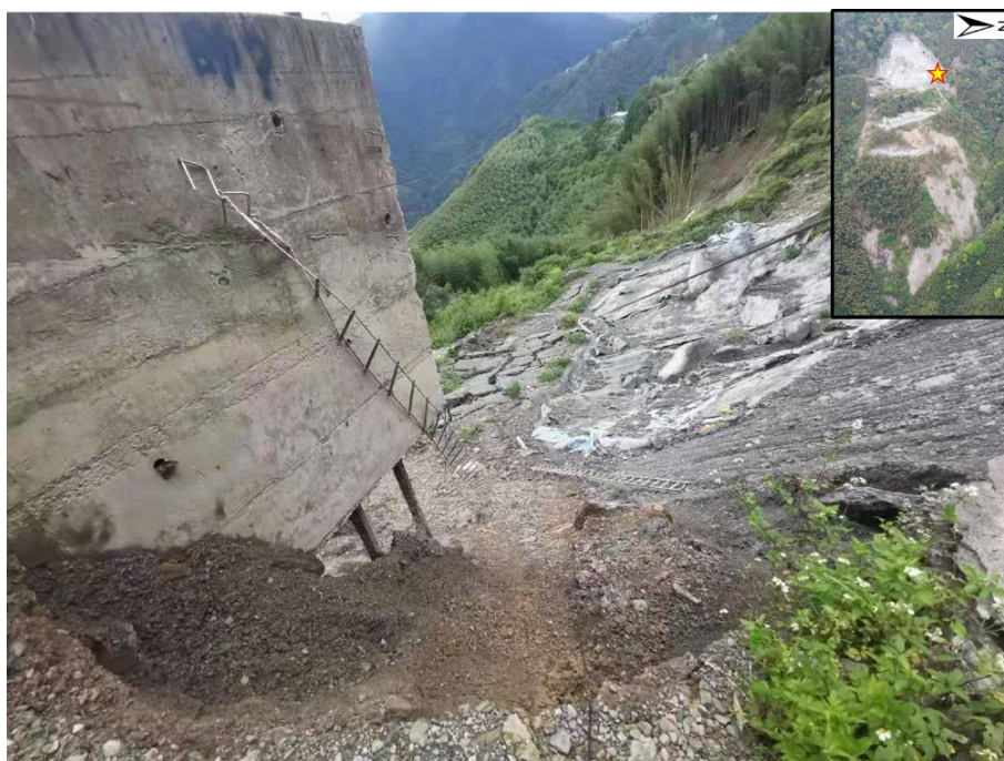
圖 3- 17 邊坡擋土牆路基流失 (拍攝日期:2021/08/17，拍攝方位角: 135 度)
