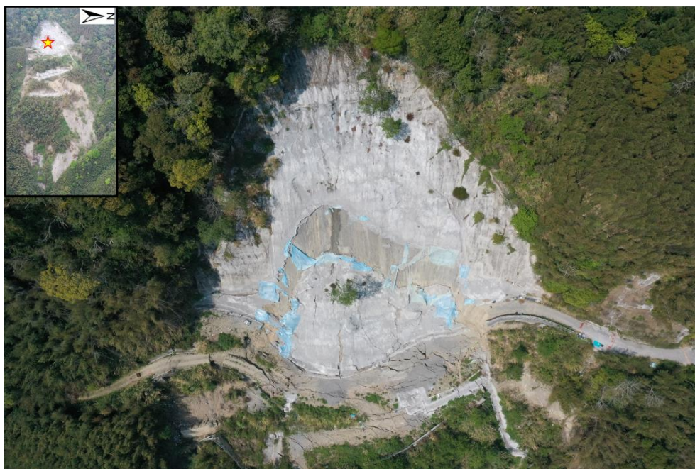
圖 3- 10 噴凝土護坡已有明顯裂隙產生 (拍攝日期 2021/3/20)
