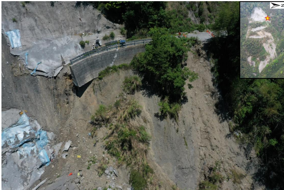
圖 3- 11 光華農路路基流失與形成現生裸露崩塌地 (拍攝日期 2021/6/17)
