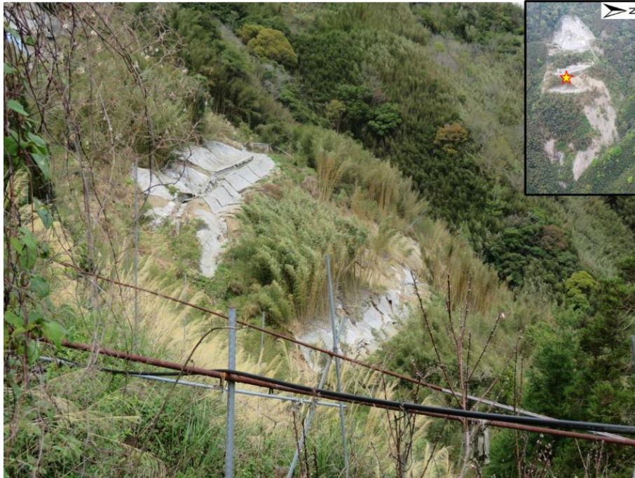
圖 3-18 邊坡工程有多處毀損 (拍攝日期 2021/03/08，拍攝方位角: 0 度)
