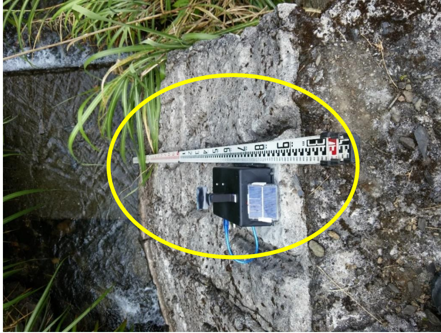
圖 5 崩山湖上游水位計裝置
