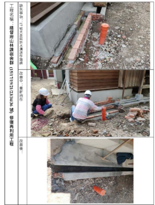
■ 犬走及排水溝施作錯誤
