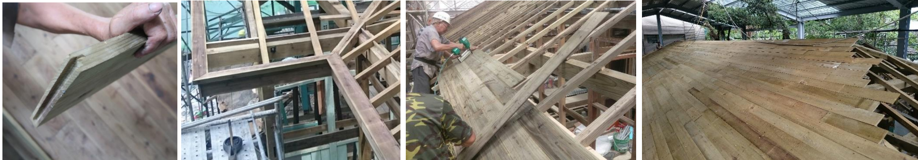
■ 屋面修復 – 木料開榫(文武榫) --> 廣小舞及封簷板組裝 --> 屋面板組裝
