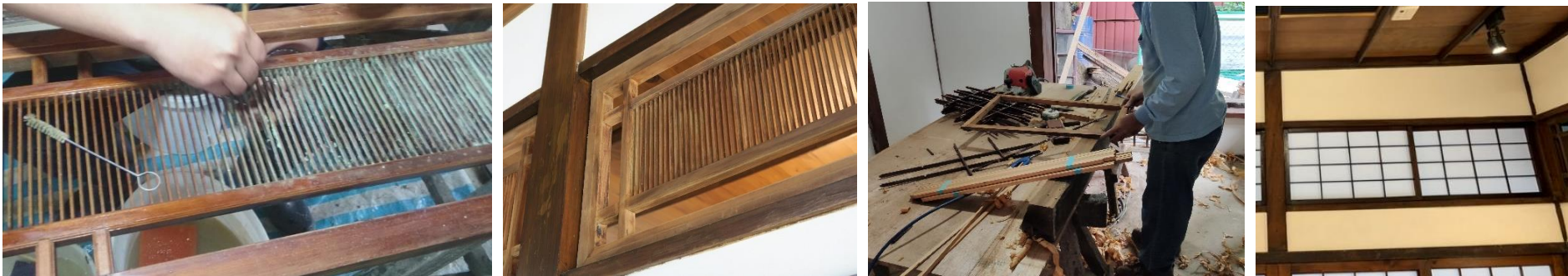
■ 既有門窗檢修 – 表面去漆 --> 損壞檢修/抽換 --> 塗刷護木漆 --> 貼附和紙/壁紙/玻璃
