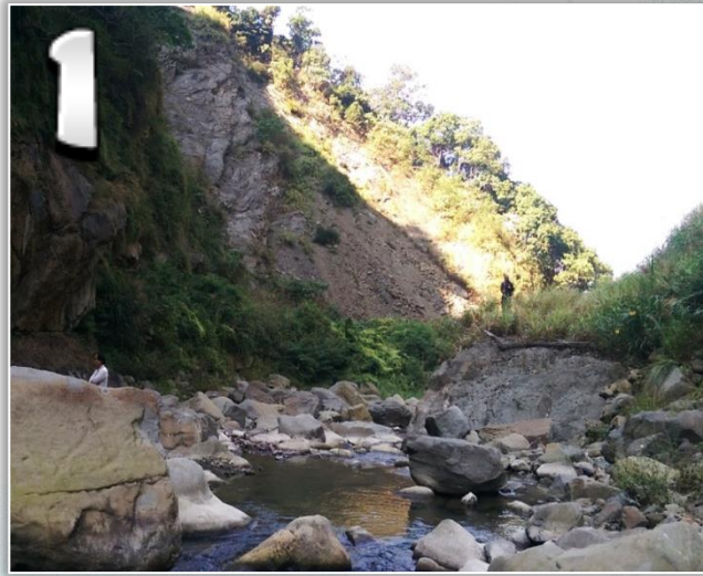
1 邊坡崩塌致災
