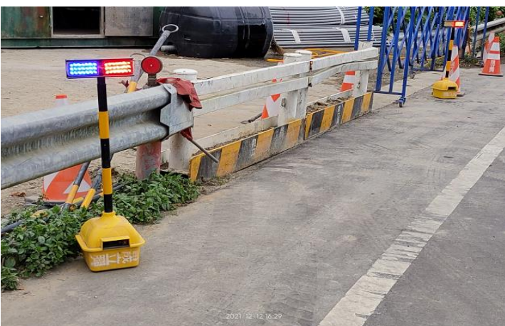
出入口警示情形
