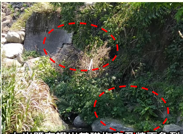
左岸既有護岸基礎掏空及牆面龜裂
