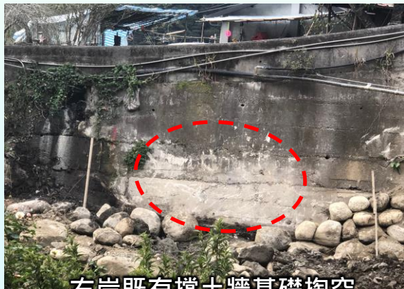
右岸既有擋土牆基礎掏空
