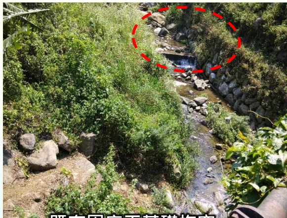
既有固床工基礎掏空
