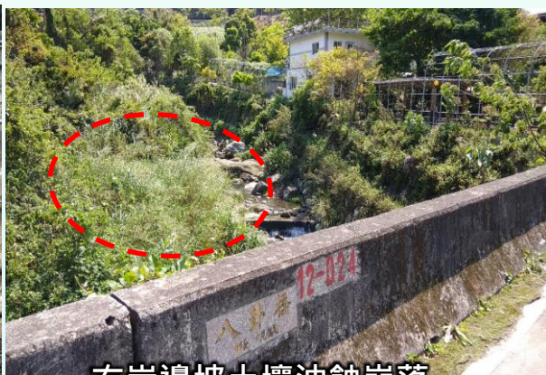
右岸邊坡土壤沖蝕崩落
