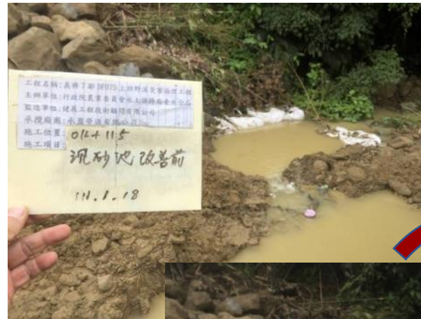
沉砂池深度不足及入水口缺乏保護設施
