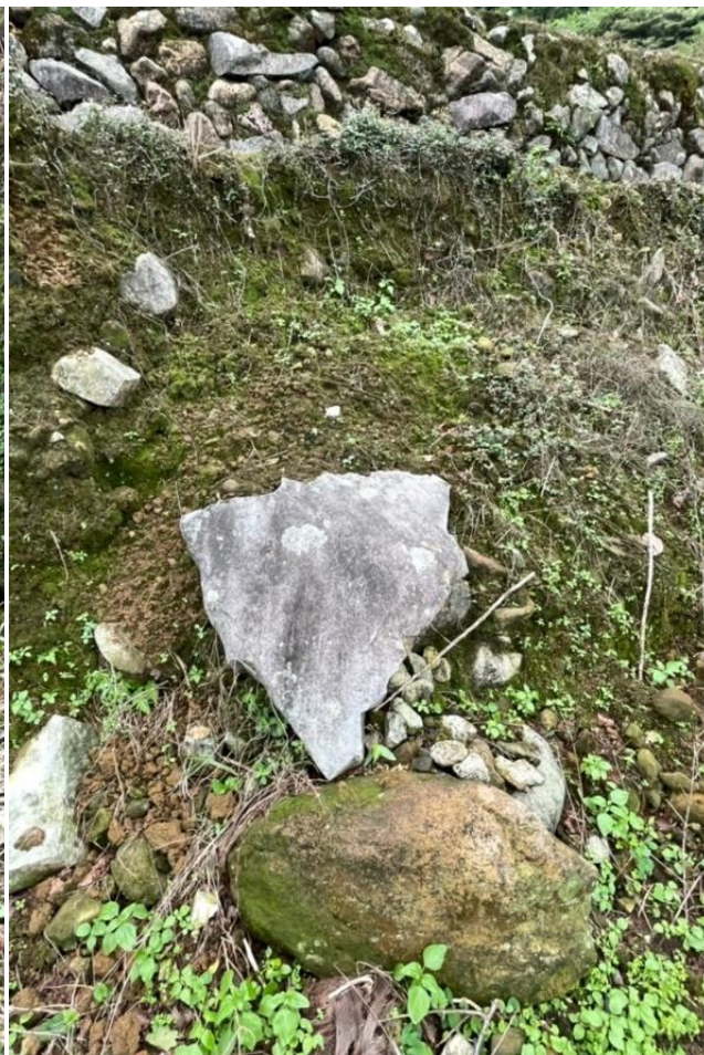
鄰近砌石護坡崩頹樣態(二)
