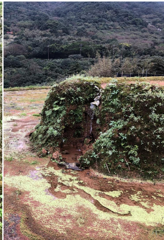
鄰近土坡沖刷崩毀樣態
