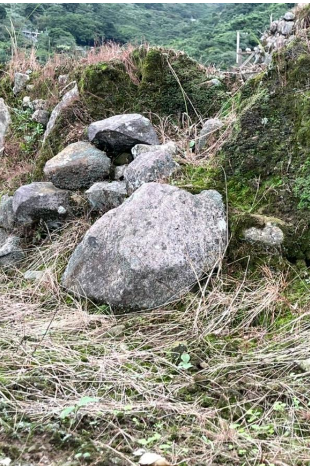
鄰近砌石護坡崩頹樣態(一)
