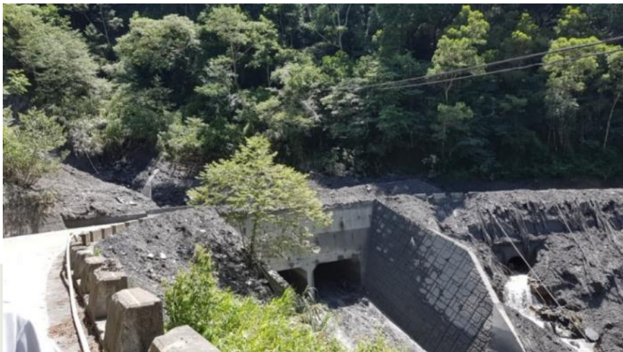
106年6月2日豪雨後箱涵堵塞情況輕微 (106.6.5)
