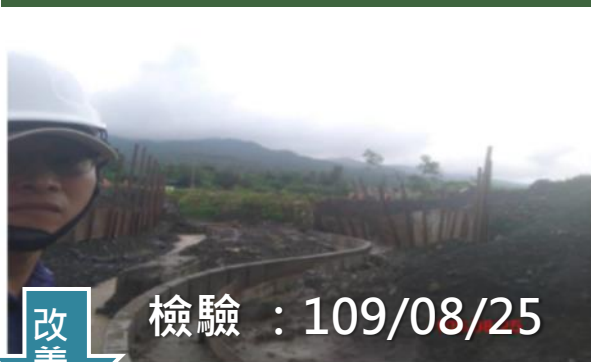
臨時擋土設施於下雨後有傾斜
