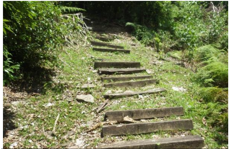
好漢坡階梯毀損嚴重，影響行走安全
