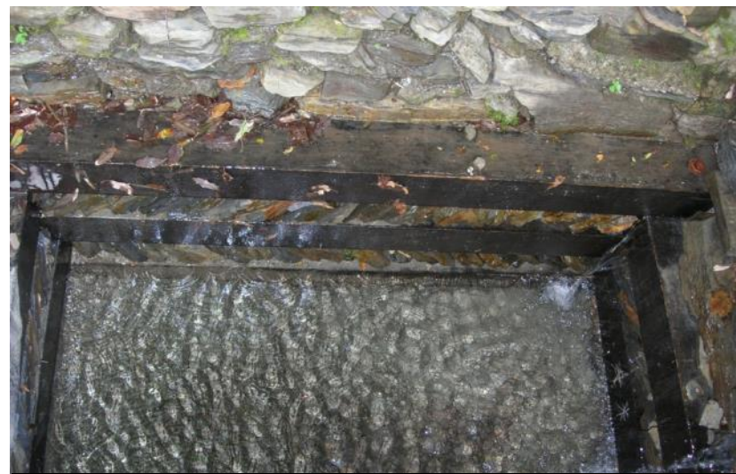
雨後地下水位高，滲流水可由格框砌石孔隙流入
