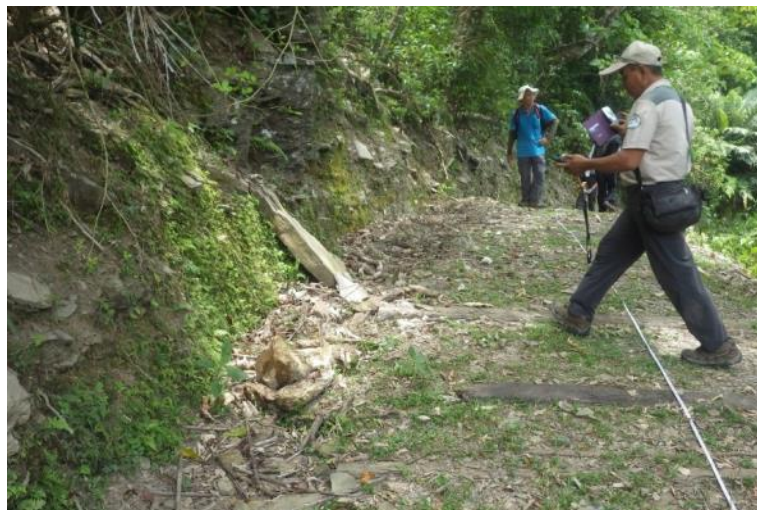
縱向土溝淤積且缺乏橫向排水
