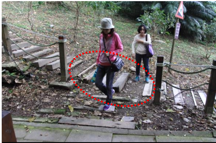
階梯銜接涼亭未設有平緩停等空間
