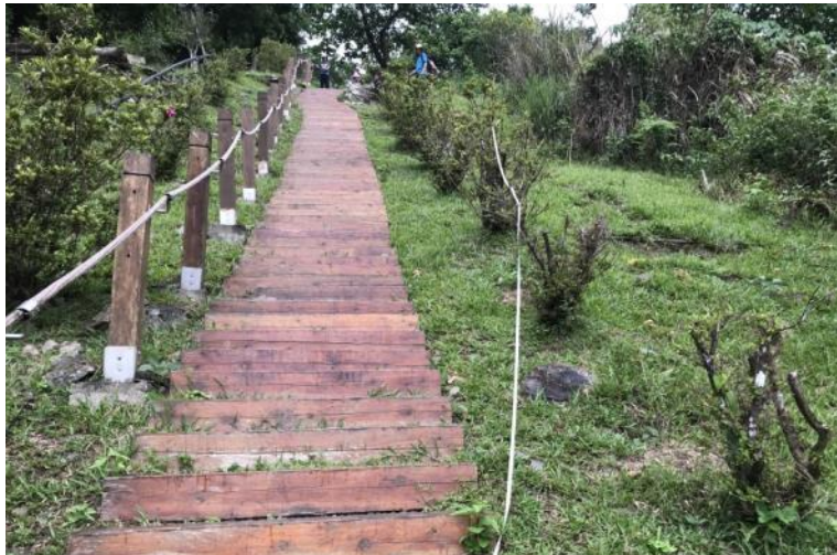
好漢坡步道坡度陡，且級深部分不合法規
