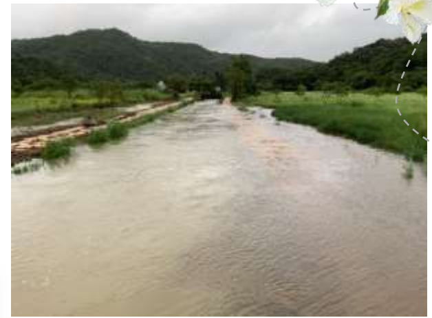
土堤步道遇雨季漫淹後坍塌維護不易
