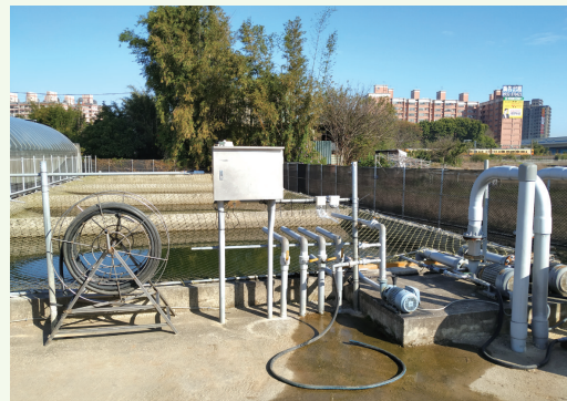
▲農場設置大型蓄水池，採用2台7.5馬力的抽水馬達供應全區溫室灌溉。
