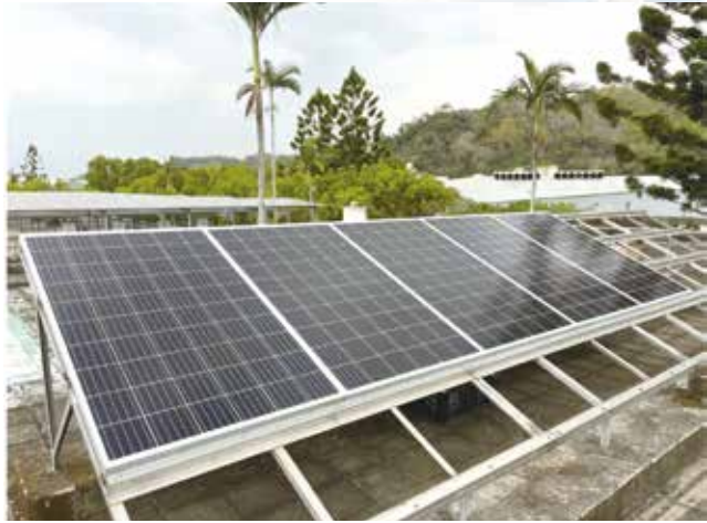
圖一、太陽能發電模組(農工大樓屋頂平台處)。
