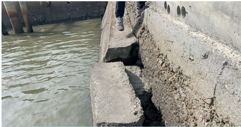
B 護岸破損現況照片
