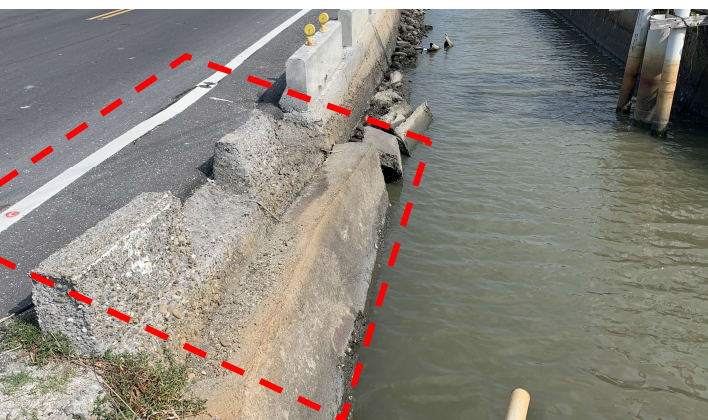
護岸破損導致路面沉陷
