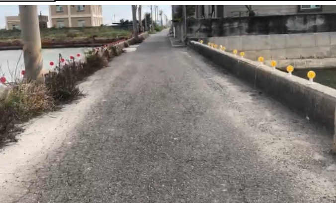
路面龜裂破損且表面剝離骨材磨光
