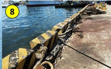
8 南碼頭-護岸破損
