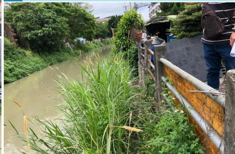
D 鄰水側護欄高度不足
