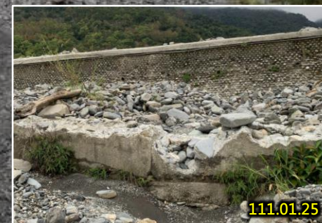
尾檻破損嚴重
