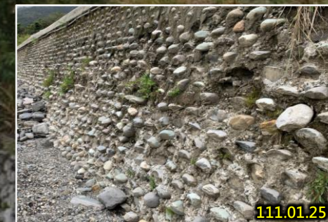
外部老舊破損
