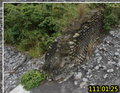
翼牆受撞擊破損
