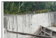
說明:水墊側牆(左岸)螺桿外露 請剪除 0k+187(照片一)
