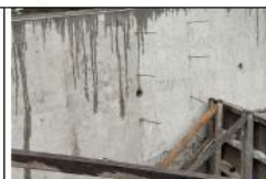
說明:水墊側牆(左岸)螺桿外露 請剪除 0k+187(照片二)
