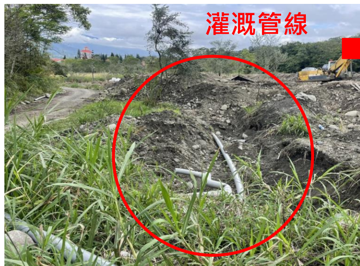
施工中挖到既有管線
