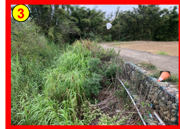
原箱籠式護岸破損
