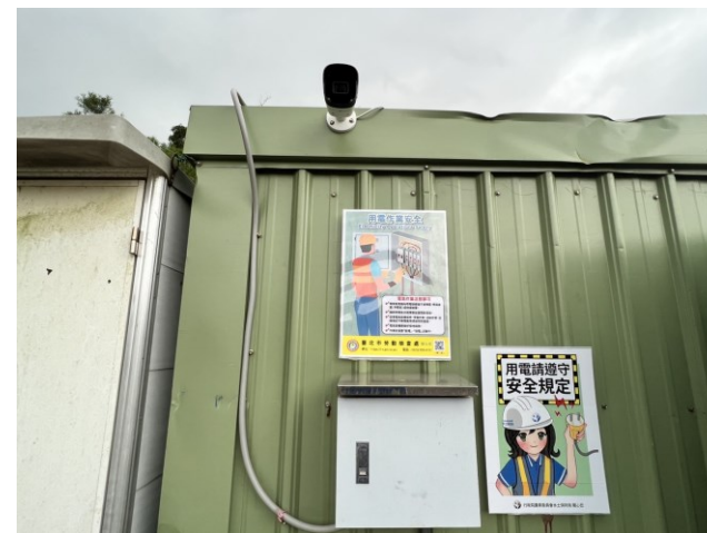
設置CCTV即時監控設備
