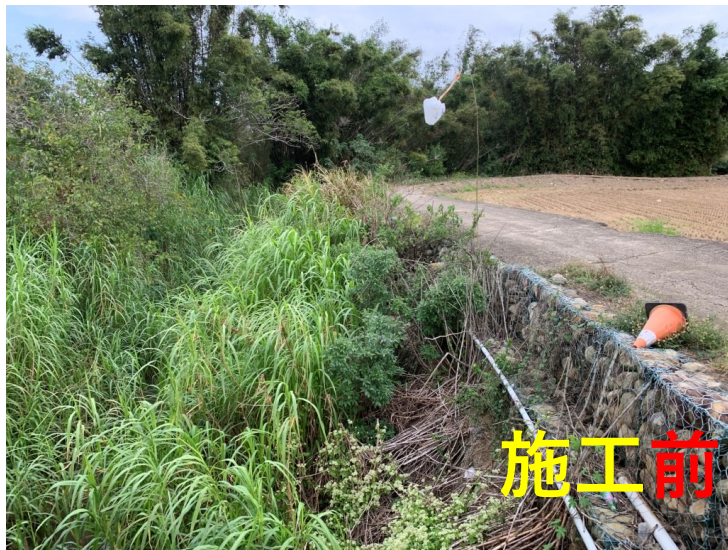
原箱籠式護岸破損
