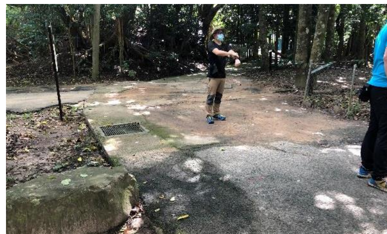
道路位於相對低點，嚴重淤土
