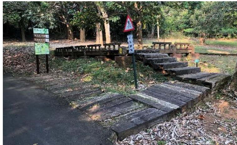
既有木構設施腐朽毀損嚴重
