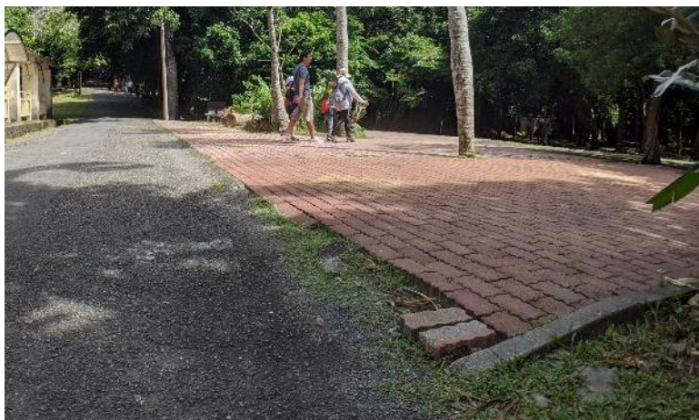
節點廣場鋪面毀損嚴重
