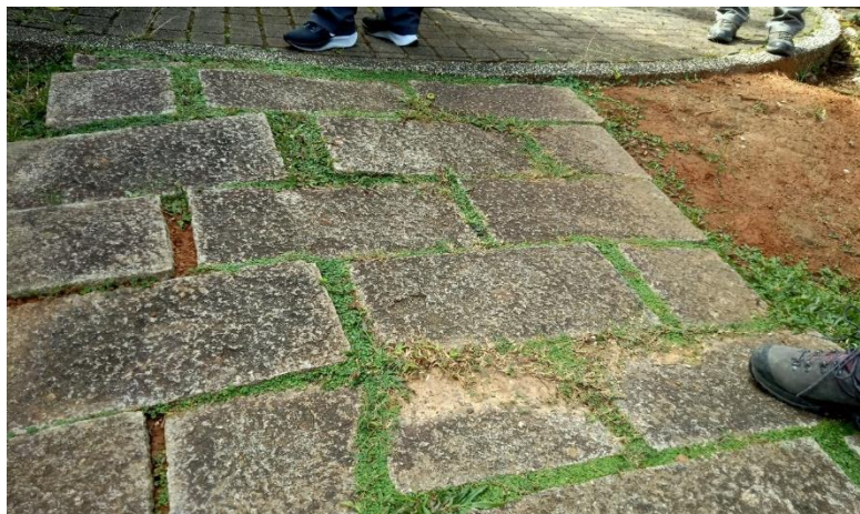
樹根影響破壞銜接廣場之步道鋪面
