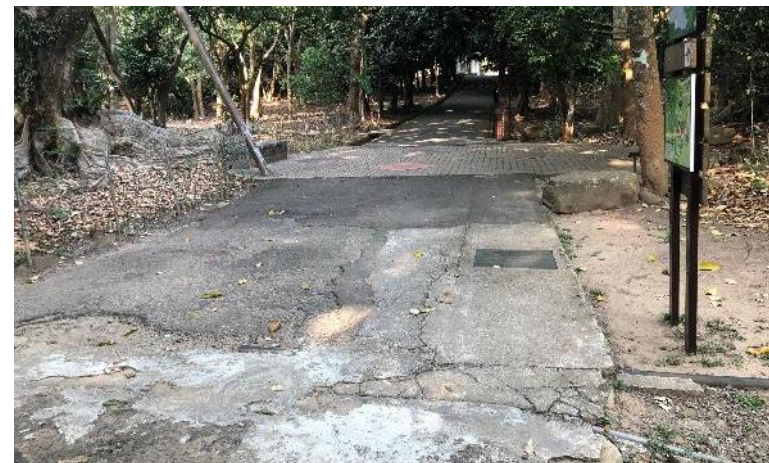
AC鋪面毀損嚴重
