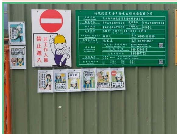
警告標語設置
