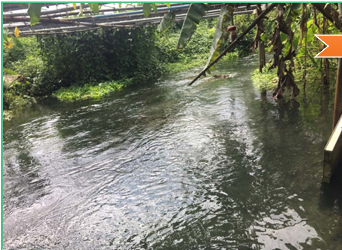
施工前 既有湧泉溝局部崩塌
