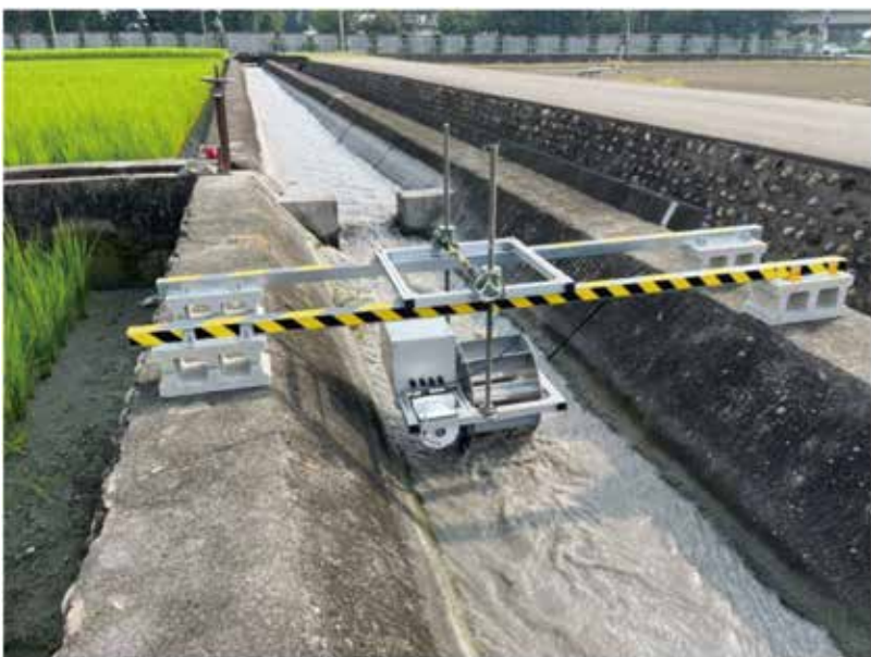
圖二、本所後方水稻試驗田區旁水圳設置水輪式微水力發電儲能設備。
