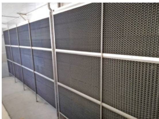
▲圖9. 畜舍後方之循環水淋洗除臭系統。
