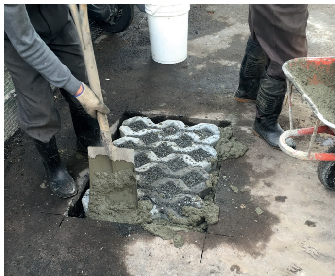
■ 200 餘歲老榕樹生長基地幾乎被覆滿柏油，僅在植穴周邊鑿孔對改善亦十分有限，最終研議方案：在樹冠投影線外圍開鑿 6 處 80×40 公分的通透口，以改善地下環境。
