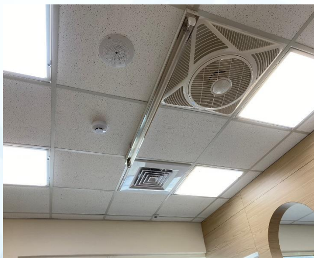
辦公室循環冷散機
