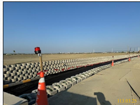
夜間警示設施
