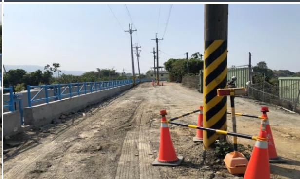
電桿周遭擺放警示設施
