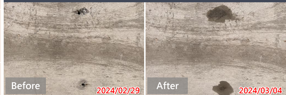
模板螺桿套管孔洞未填補
