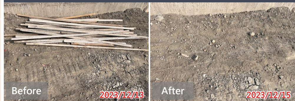
模板殘料未處理
