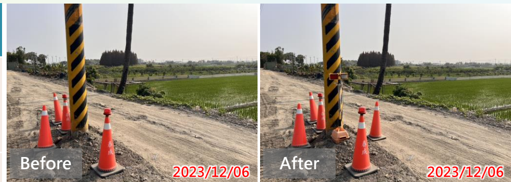
交維設施未確實擺放
