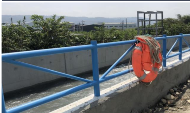
防汛設備確實擺放
