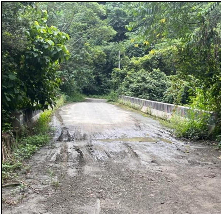
橋梁銜接處下陷
