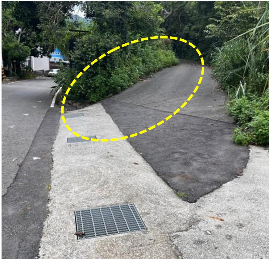
交會路口坡度陡(工程起點)
