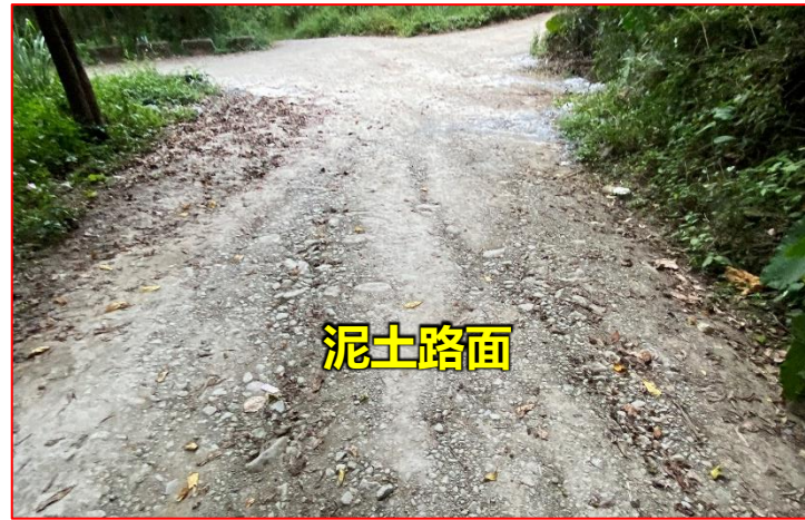
逕流冲刷形成蝕溝
