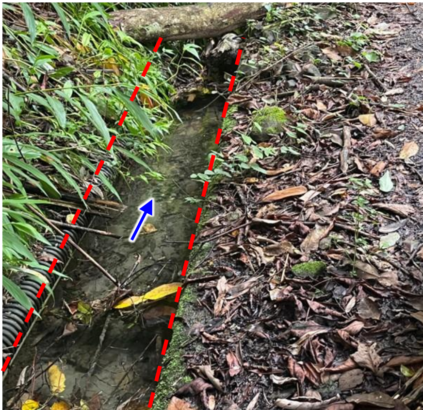
道路邊溝淤積
