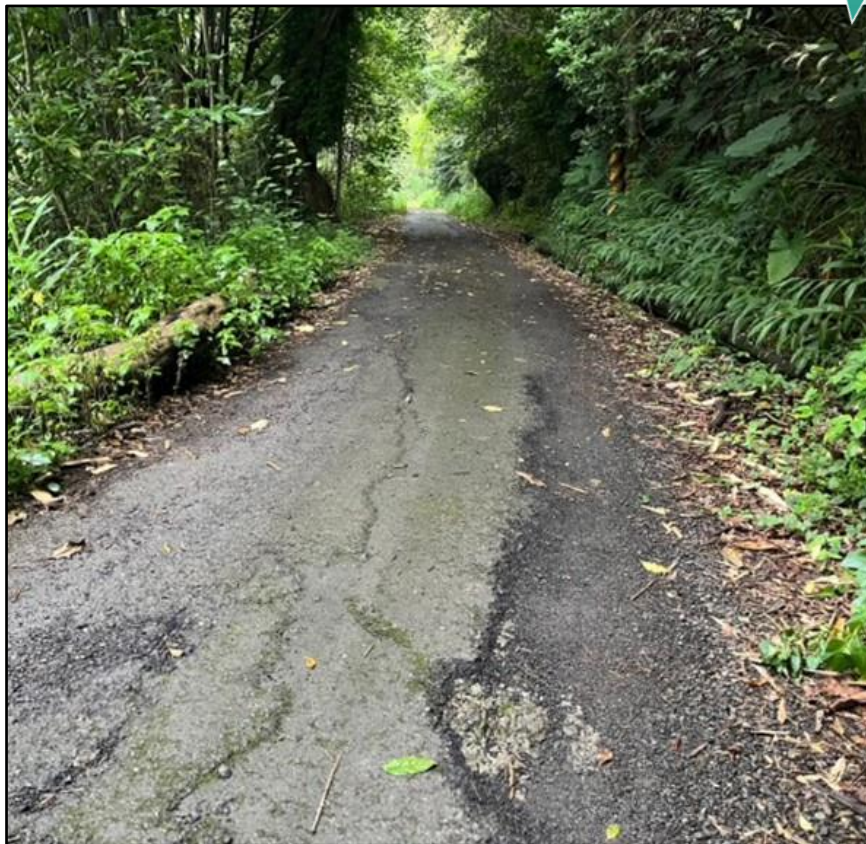
鋪面劣化損壞
