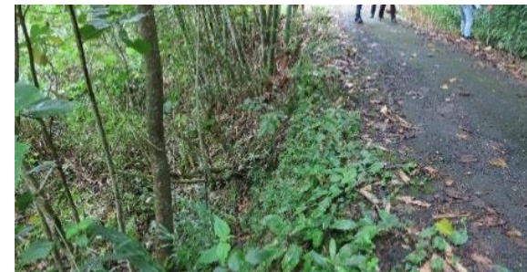
既有農路路基崩塌
