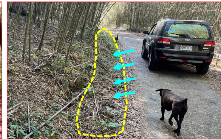
路面逕流冲刷坡趾
