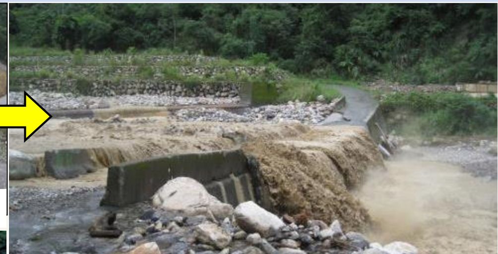
過水路面 通洪斷面不足
