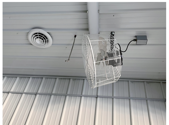
(d) 循環扇前方有加濕器及冷 / 熱空調出風口。
